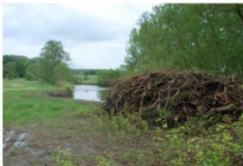
Travaux de restauration de la Martagne (Communauté de Communes de la Martagne, CC 54, Agence de l'eau Rhin-Meuse), Xermaménil.
