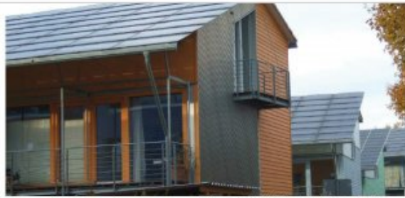
Panneau solaire faisant office de couverture "Toiture intégrée" dans la "Solariedlung" à Fribourg, Allemagne.
